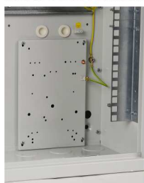
Pusta blacha montażowa
