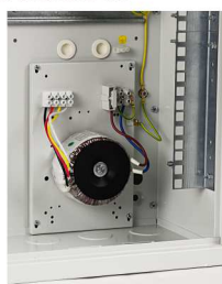
Transformatory serii TOR...
